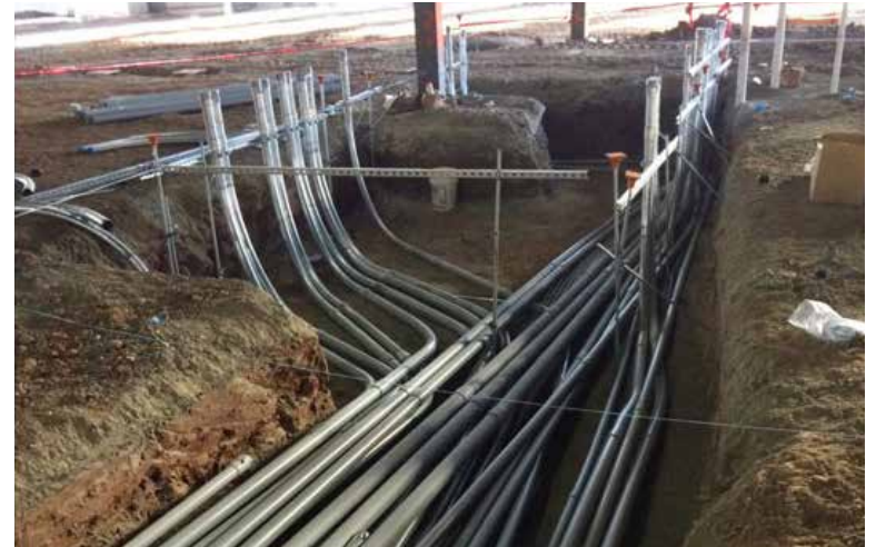
▼ UNDER-SLAB ELECTRICAL CONDUIT
